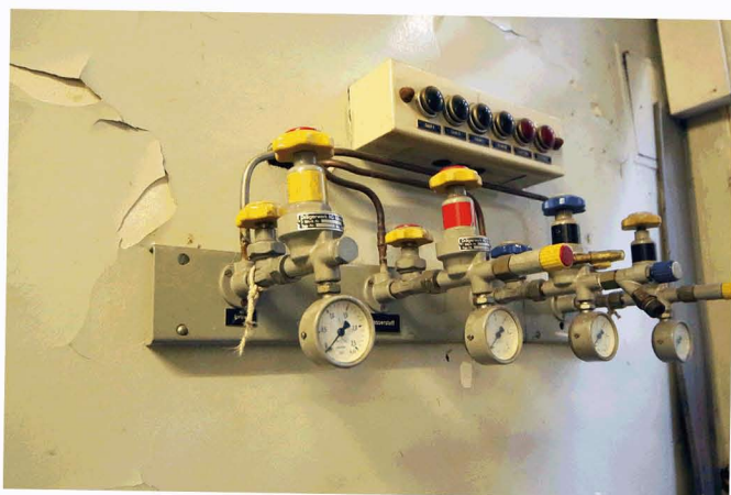
Abbröckelnder Putz, freistehende Gashähne und Leitungen, keine sanitären Einrichtungen und Umkleidemöglichkeiten für die Mitarbeiter - ein "Vorzeigeprojekt des Freistaats Bayern", wie die Reptilienauffangstation einst mal von einer Behörde genannt wurde, sieht wahrlich anders aus.
